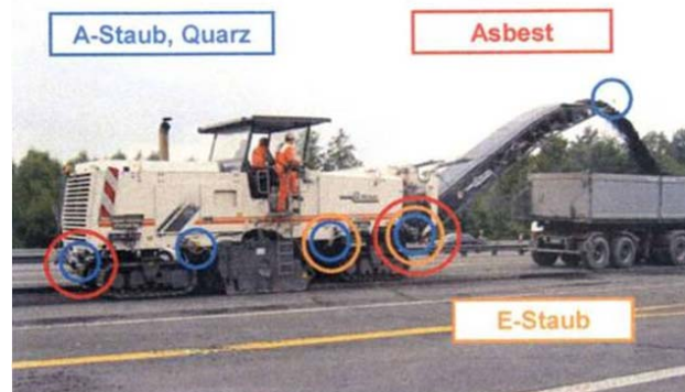
Frässtaub kann Asbestfasern enthalten Foto: BG Bau
