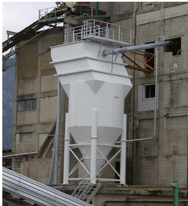
Bild 1: Aufstellsituation der Behandlungsanlage mit LEIBLEIN-Schrägklärer
