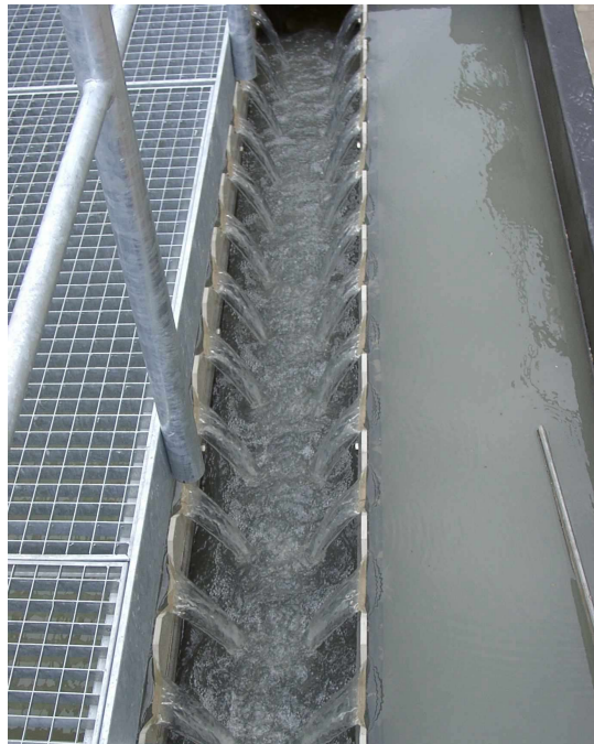
Bild 2: Klarwasser-Überlauf beim LEIBLEIN-Schrägklärer
